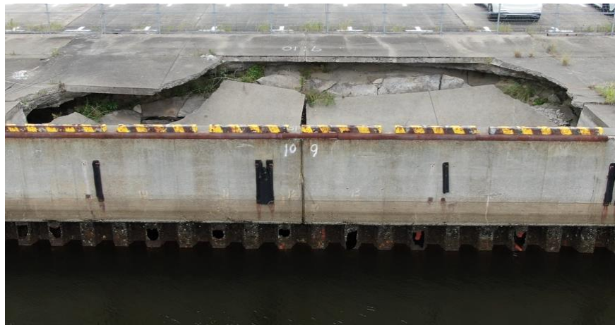
図1 陥没した港湾岸壁
