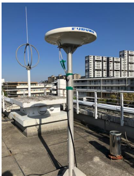
写真 3 古野電機製サテライトコンパス SC-50 受信アンテナ外観
